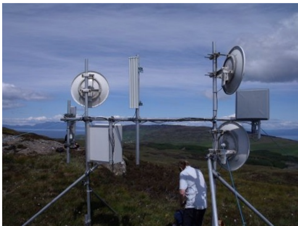
Un relè con tre collegamenti punto-punto e tre antenne settoriali. Progetto Tegola.
